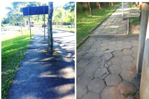
Figuras 2 e 3: evidências de problemas no campus como desníveis na calçada e pedras soltas
